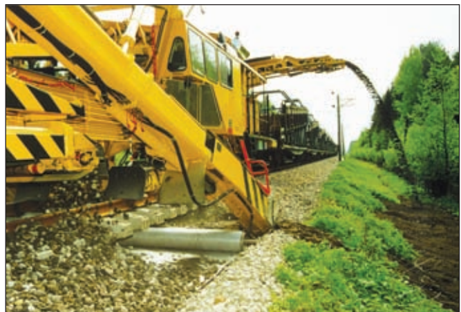
Фото 2. Реконструкция железной дороги Москва – Санкт-Петербург производилась с применением геотекстильного полотна марки Тураг (источник: ООО «Дюпон Наука и Технологии»)
